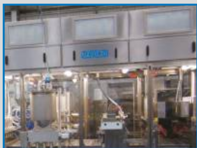
komorę nadmuchu czystego powietrza z filtrami HEPA
